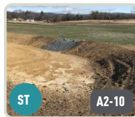
ST A2-10 SEDIMENT TRAP
